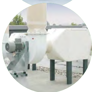
Sistema de filtración de 6 planchas
